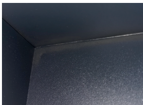
Épaisseur de couche insuffisante dans les arêtes
