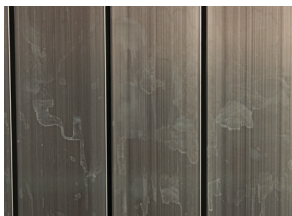
Taches sur la pièce revêtue
