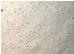
Nadelstiche in Lackoberfläche
